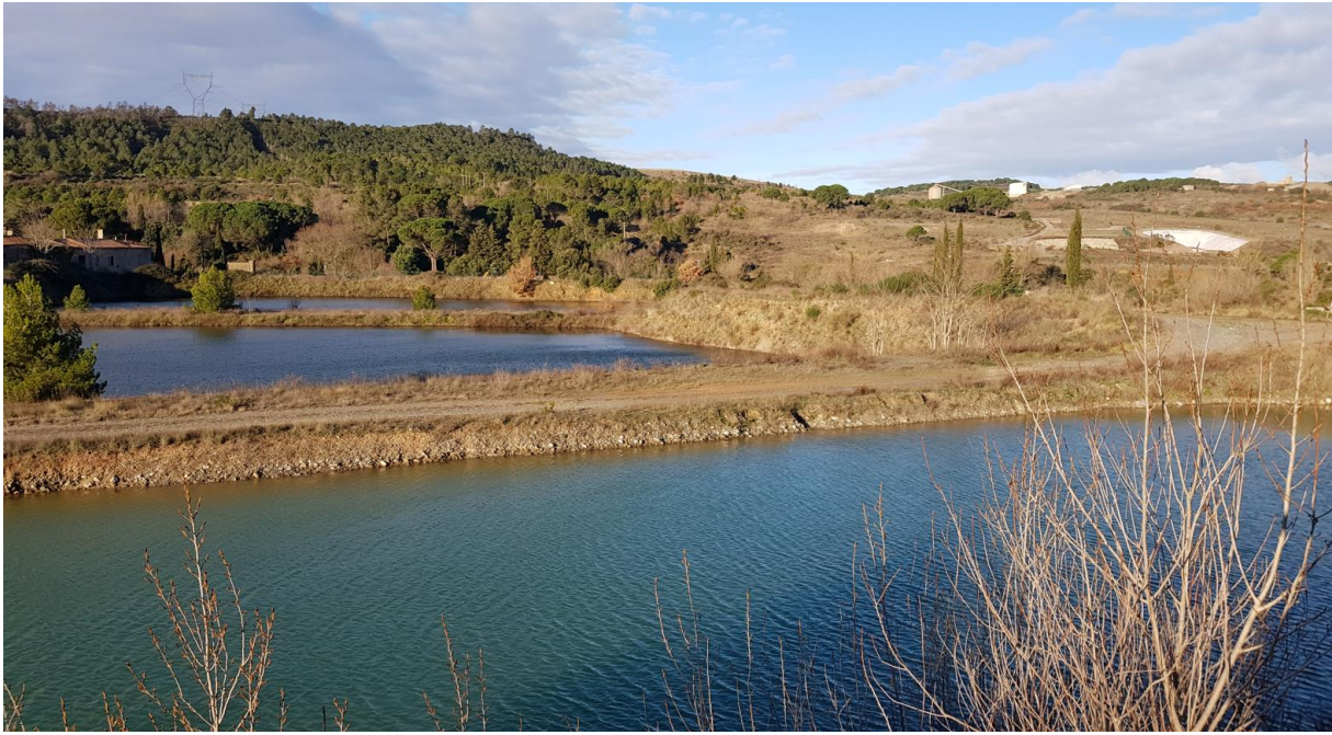
Point d'observation 8 : 4 zones d'érosion décimétriques sur la digue entre les bassins 3 et 4
