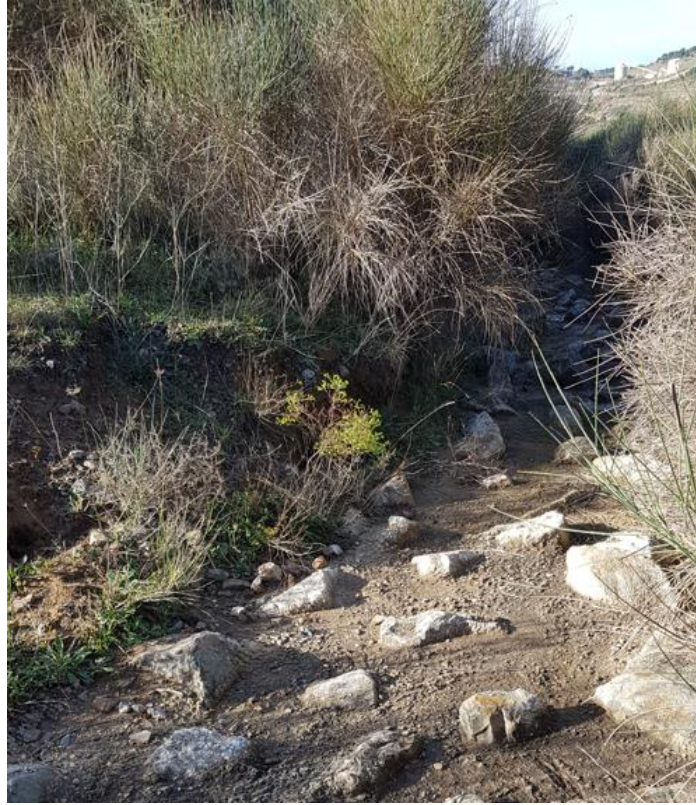
Point d'observation 33 : Mise à nu des résidus miniers devant enrochement (partie haute de la rampe)
