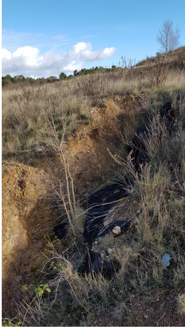
Point d'observation 12: zone d'évacuation de la buse de sortie du bassin (forte érosion)
